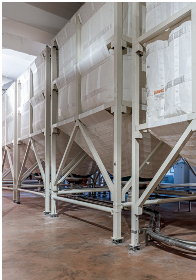
LE SOLUZIONI AGRIFLEX NELLO STABILIMENTO DI SAN GIORGIO. AGRIFLEX SOLUTIONS AT THE SAN GIORGIO PLANT.
